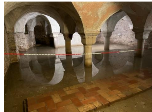
↑教会の地下室に水が張っている様子
